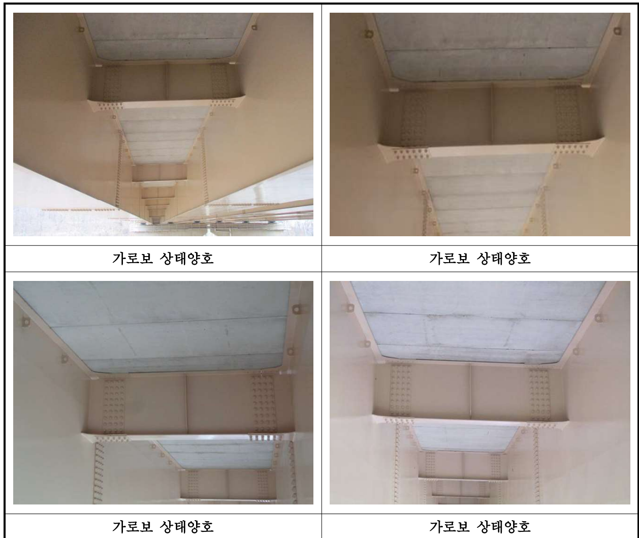
【사진 5.3.7】 가로보 손상현황
